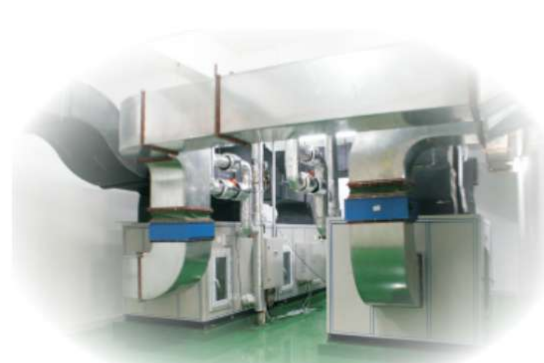
图1-5 加衡制剂生产专用空调机组
